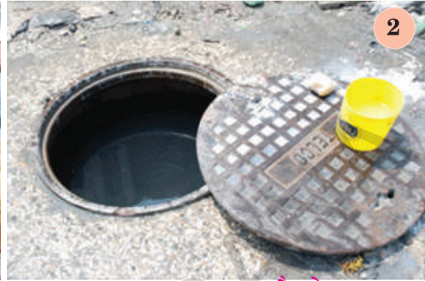
सड़क पर खुला पड़ा मैनहोल
