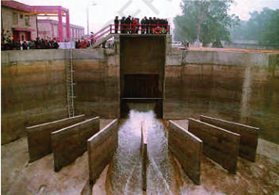
شکل 18.10 : واٹر ٹریٹمنٹ پلانٹ
