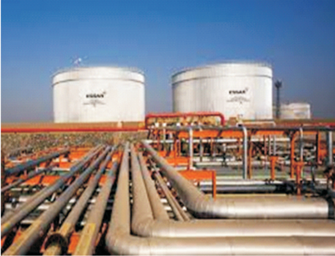
चित्र 17.1 : पेट्रोलियम पाइपलाइनें
