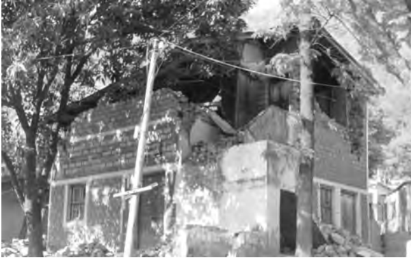
شکل 7.1: زلزلے سے تباہ ایک عمارت
